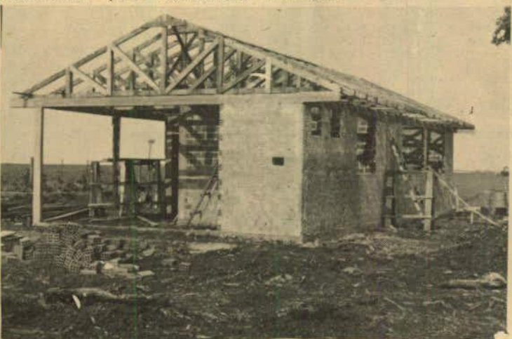
Escola Fazenda Puhl - Padrão Fudnepar, em convênio com Itaipu - Área construída 89,00 m 2 - Custo Cz$ 147.000,00
